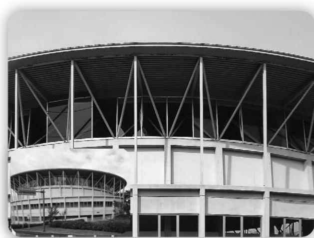
破損したアリーナのガラス
