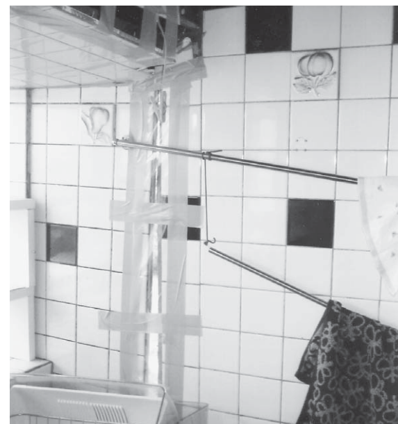
被害家屋（大きく亀裂の入ったタイル）
