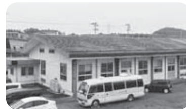
老朽化した屋根（武道館）
