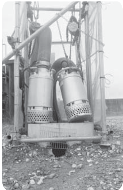
要害の仮設ポンプ
