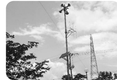
設置済みの防災行政無線子局
