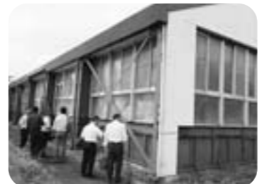
老朽化の町民プール
